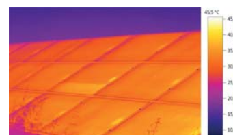
Thermografieaufnahme zeigt Defekte in Solarmodulen
